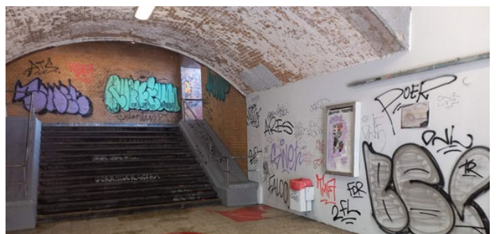
Haltestelle Köln-West (verunreinigt)
