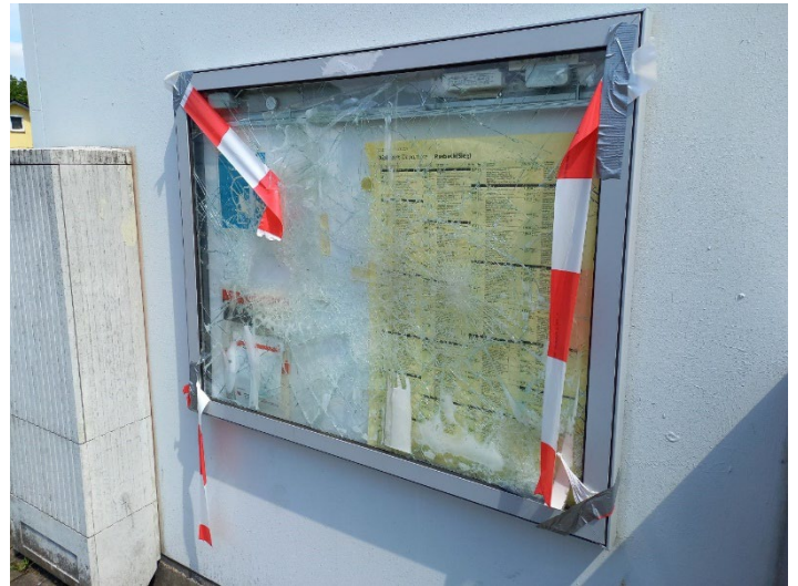
Vandalismus an der Station Rosbach
